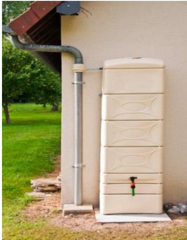
Système de récupération des eaux pluviales en façade- Source : 123RF/delcreations
