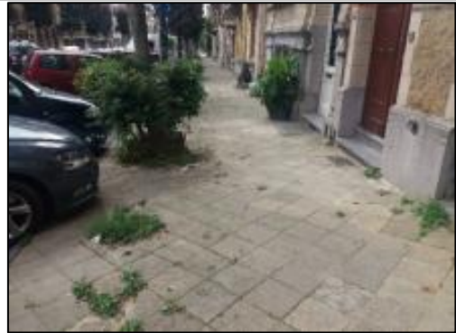
Figuur 131: Toestand van de voetpaden op de Victor Rousseaulaan (bron: GMP-project, oktober 2021)
